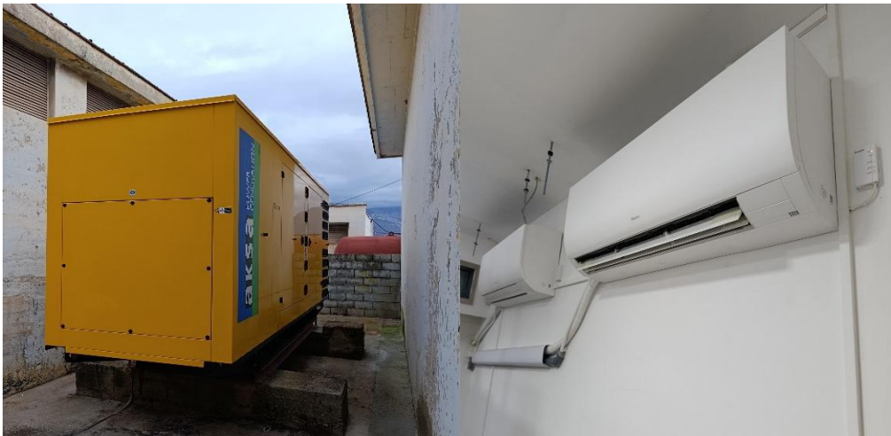
Novi dizel-električni agregat i sistem klimatizacije server sobe
