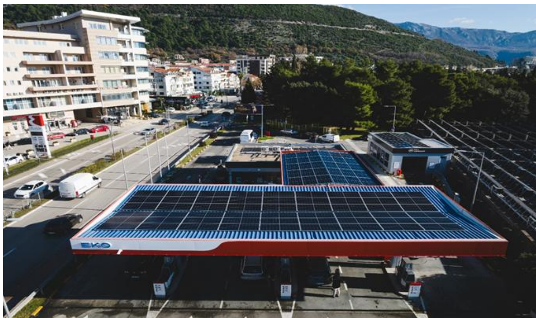
Solarna elektrana na krovu benzinske stanice Budva 1
