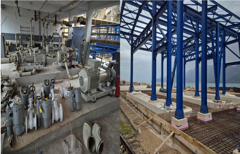
Pumpna stanica i ostrva za Novo punilište sa donjim punjenjem cisterni
