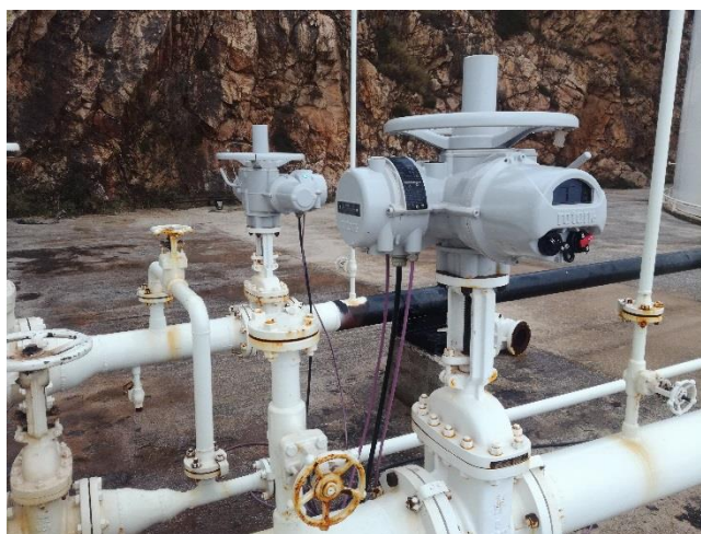
Ugrađeni motorni ventili na ulaznim i izlaznim linijama iz rezervoara
