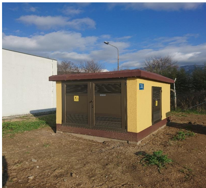
Nova trafo stanica
