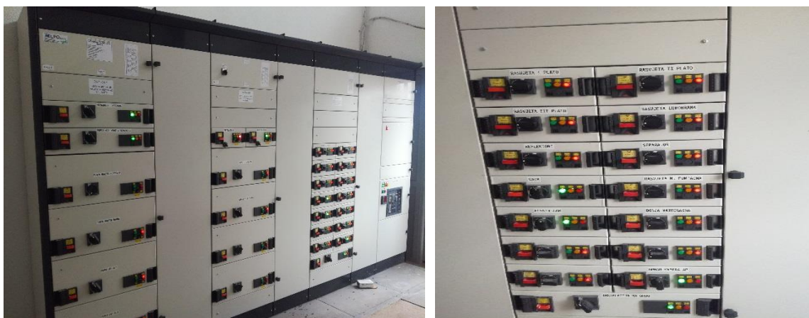
Novi ormari za napajanje i upravljanje pumpama i ostalim potrošačima
