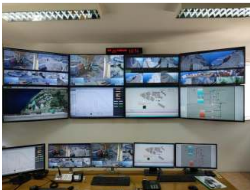
Kontrolna soba sa CCTV nadzorom
